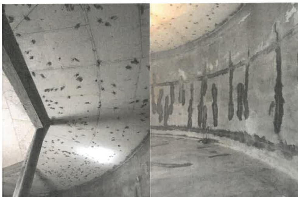
Figura 17: Tratamento do betão, fissuração e armações à vista no interior da célula
